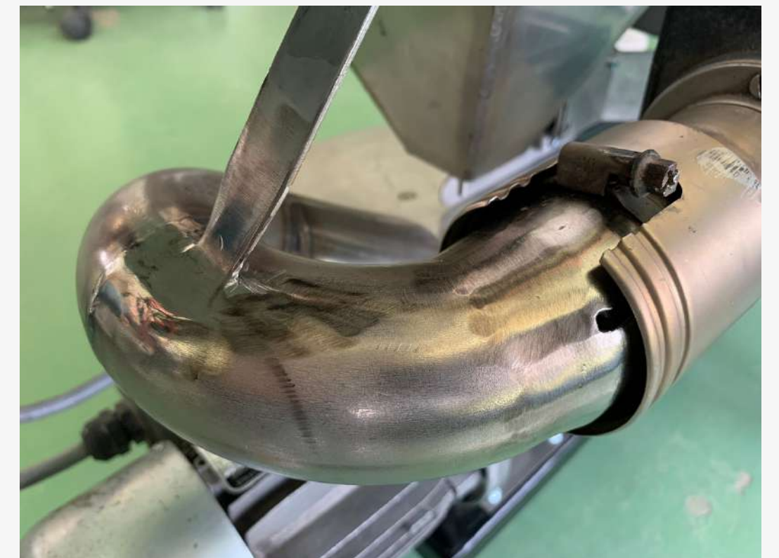
Conduit de chauffage en inox
